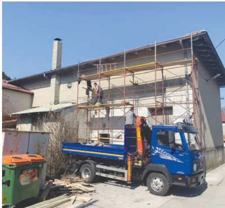
I vanjski i unutarnji dio bivše kinosale iziskuje obnovu te će realizacija morati teći korak po korak. U 2021. godini obnovljen je krov.
