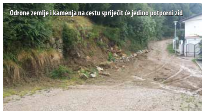
Odrone zemlje i kamenja na cestu spriječit će jedino potporni zid
