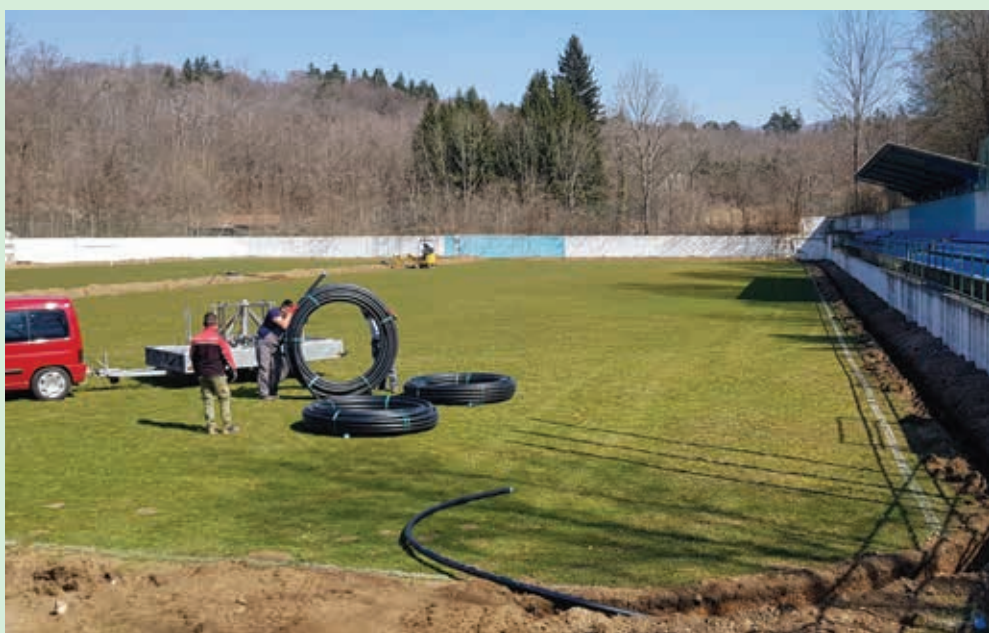
Na Graščini je ugrađen sustav za navodnjavanje terena
